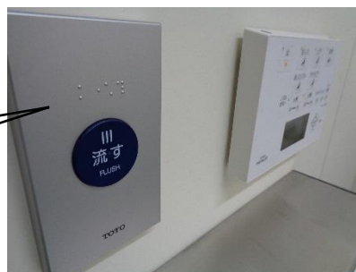
【写真2】 トイレの洗浄ボタン
